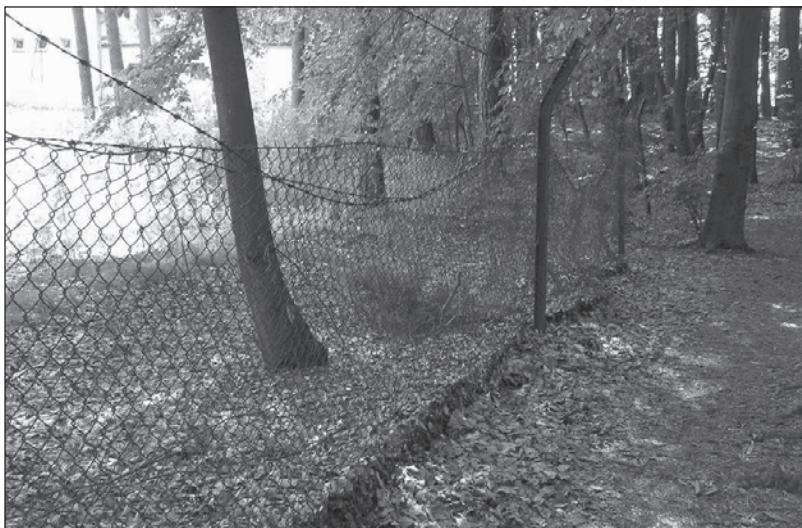
Część płotu stadionu to ruina
