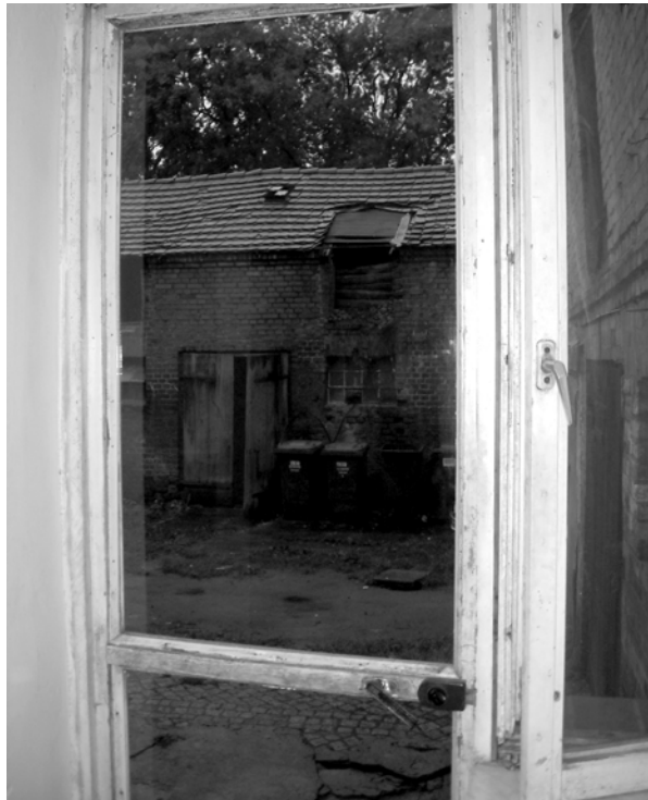
Karczewscy boją się, że przy silniejszym podmuchu wiatru okna im powypadają.
