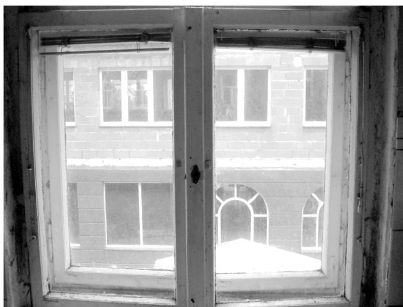
Przez rozpadające się okna mieszkańcy z zazdrością zerkają na plastikowe okna sąsiadów.
