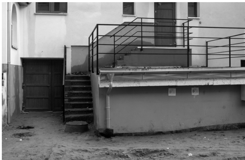
Od ul. Wałowej – wyjście ewakuacyjne ze schodów prosto we wkopaną w ziemię beczkę, a drzwiami w dziurę
