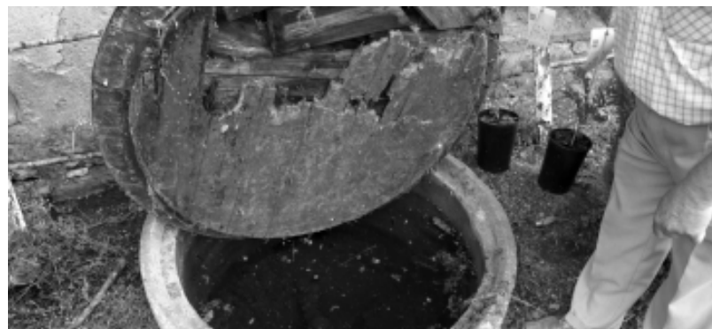
Studzienka z licznikiem, o której wspomniano na sesji, zalana wodą (foto archiwum)
